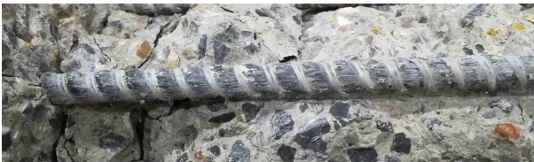
(b) 侵蚀后混凝土梁内 GFRP 筋
